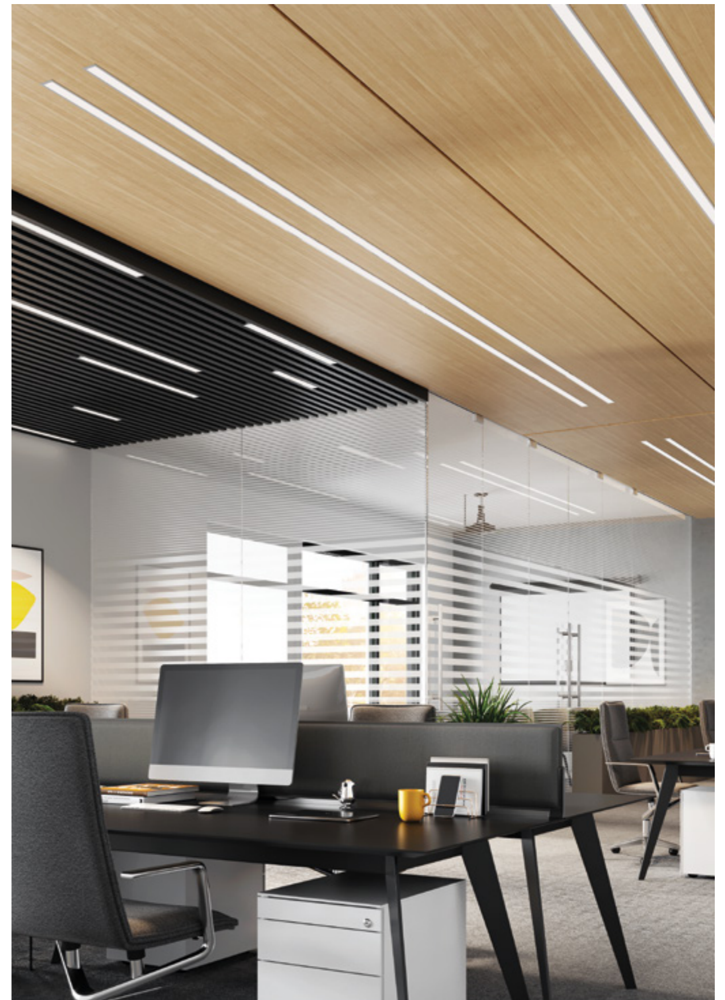
Zastosowanie podtynkowej wersji lampy Baris 52 LED w pomieszczeniu biurowym typu open space.
