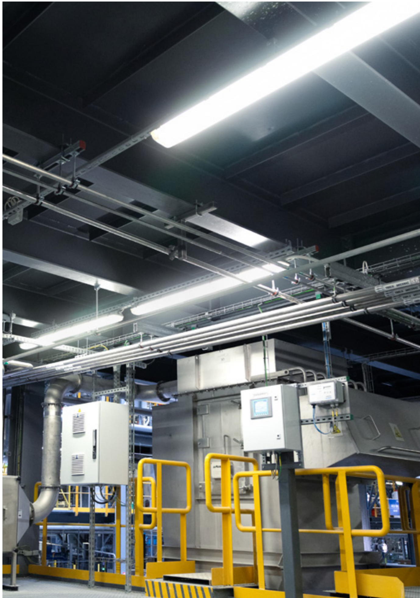
Zastosowanie lamp Tytan Multi LED Chemo w hali produkcyjnej
